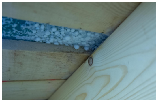
Abbildung 4 und 5: Eine fehlende Koordination lässt die Kanalstrangentlüftung im Dachraum enden, wo es durch hohe Luftfeuchtigkeit und unzureichender Dachraumventilation zur Eisbildung kommt.
