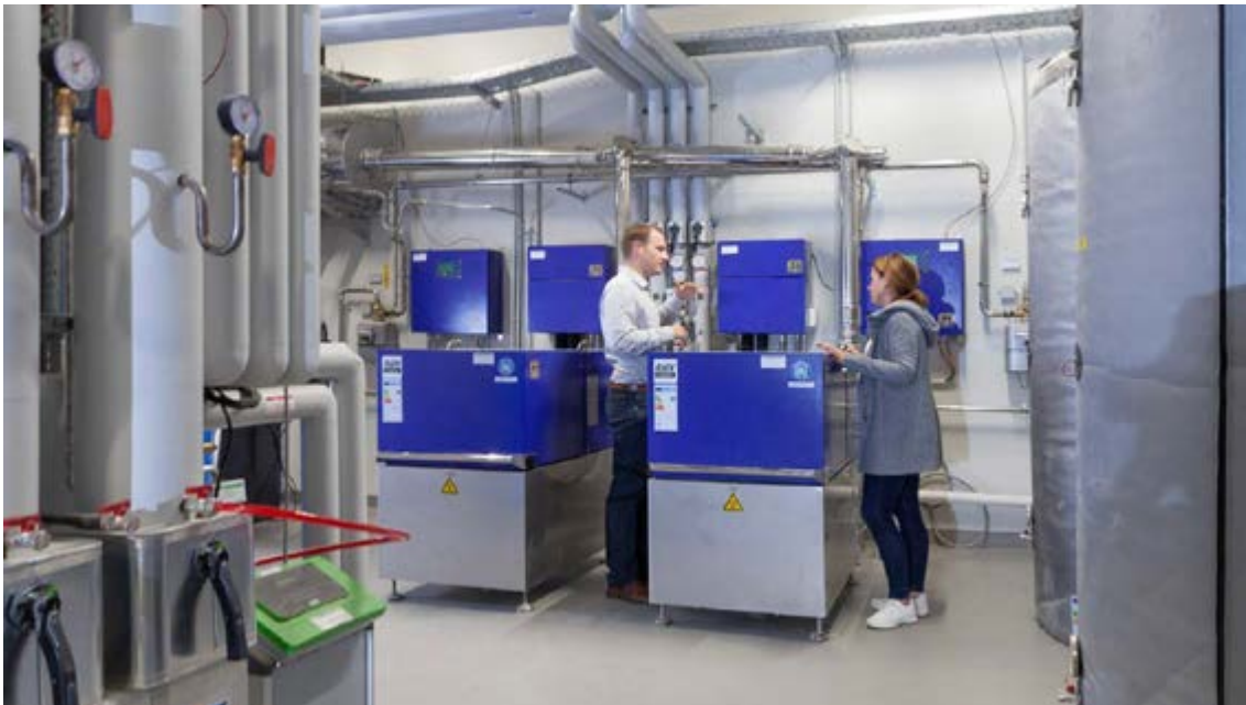
Heizzentrale mit Blockheizkraftwerken, Pufferspeicher und Heizungsverteilung. Foto: KEA
