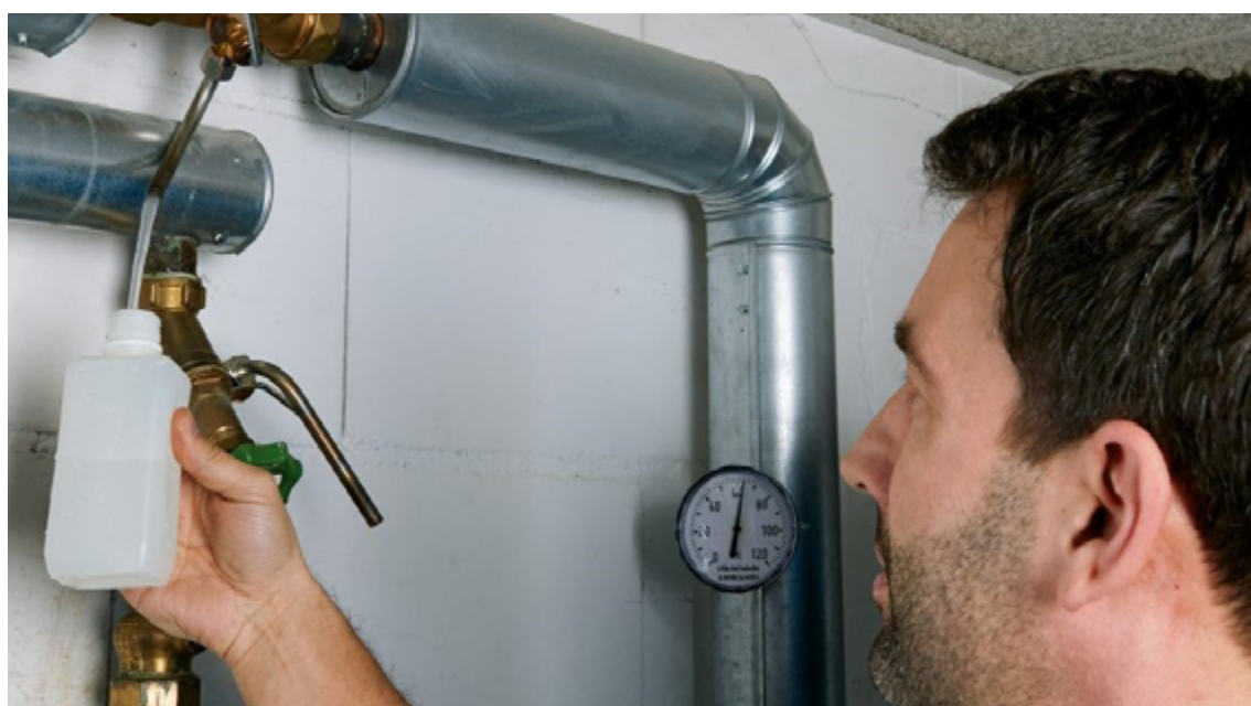
Probennahme zur Legionellenuntersuchung. Foto: Techem
