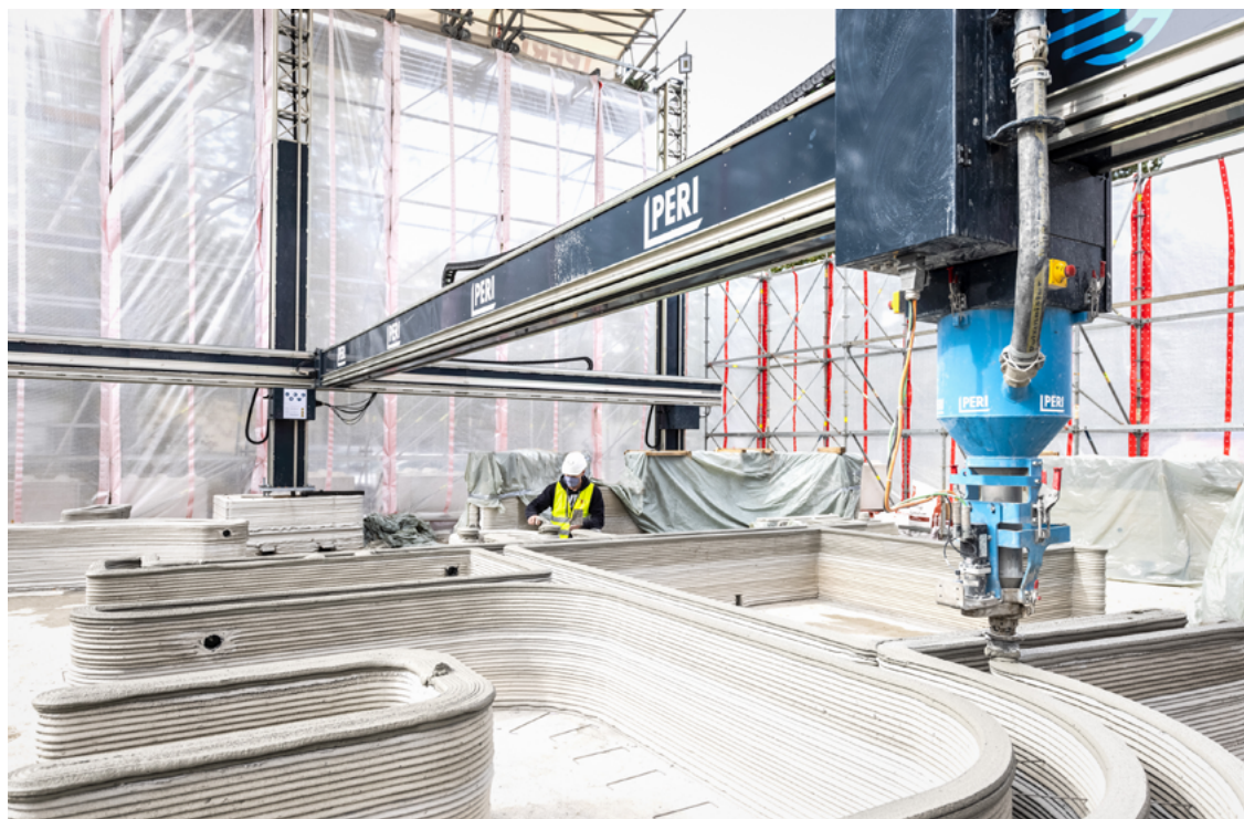
„i.tech® 3D“, das Material wurde von HeidelbergCement speziell für den 3D-Druck entwickelt. Foto: PERI GmbH
