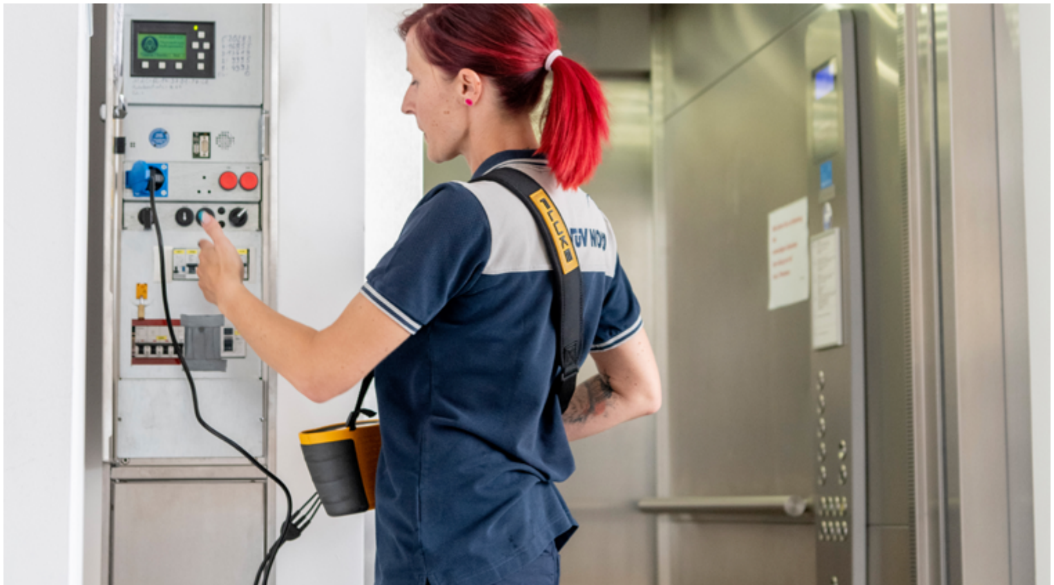
Eine Aufzugsprüferin inspiziert die Steuerung während einer wiederkehrenden Prüfung. Foto: TÜV NORD
