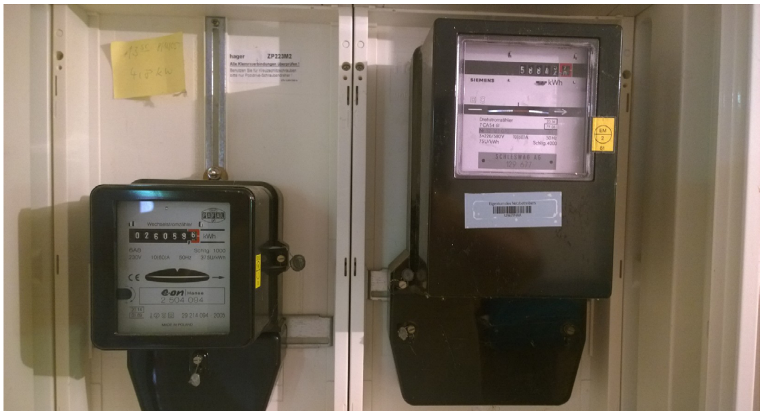
Zwei Stromzähler im Keller. Links wird der Solarstrom gezählt, rechts der Stromverbrauch. Foto. Wohnungswirtschaft-heute.energie
