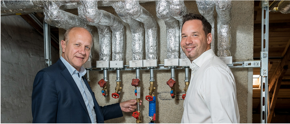
Die Sozialbau setzt auf Gemeinschaftsthermen, um CO 2 und Kosten zu sparen – zum Beispiel in der Anlage in der Miesbachgasse in Wien (links im Bild: Ernst Bach mit einem Energieexperten).
