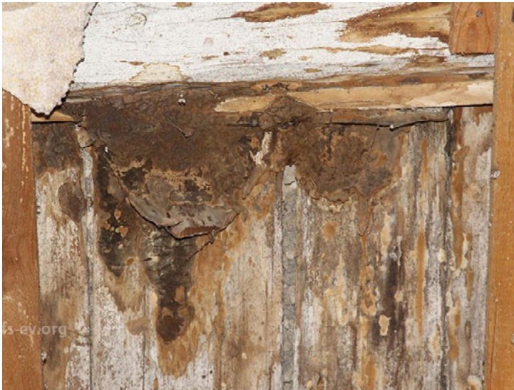
Das Holz im Fußboden zeigt erhebliche Fäulnisschäden. www.ifs-ev.org
