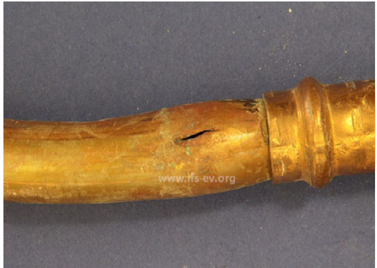
Eine Kupferleitung aus der Küchenwand ist aufgeplatzt. www.ifs-ev.org
