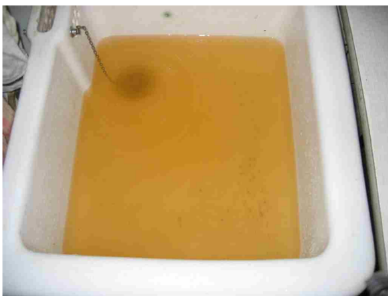
Bild 1: Rostwasser aus einer verzinkten Stahlleitung der Trinkwasserinstallation in einem Waschbecken. Bild: Dr. Georg Scholzen, Münster
