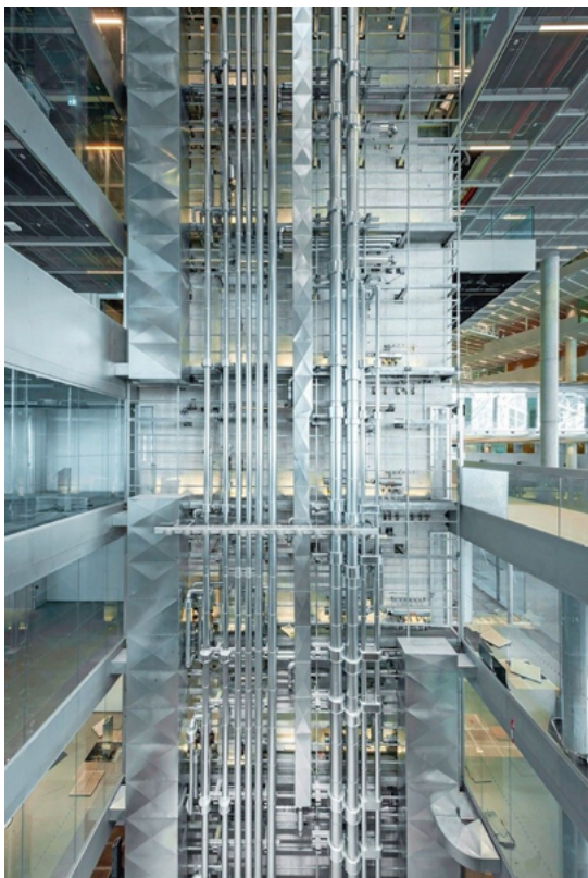
Im Bürogebäude des Axel-Springer-Neubaus (2020) ist ein aktuelles, prägnantes Beispiel für die offene, transparente Verlegung für alle Ver- und Entsorgungsleitungen in einem Lichthof demonstriert. Foto: Geberit
