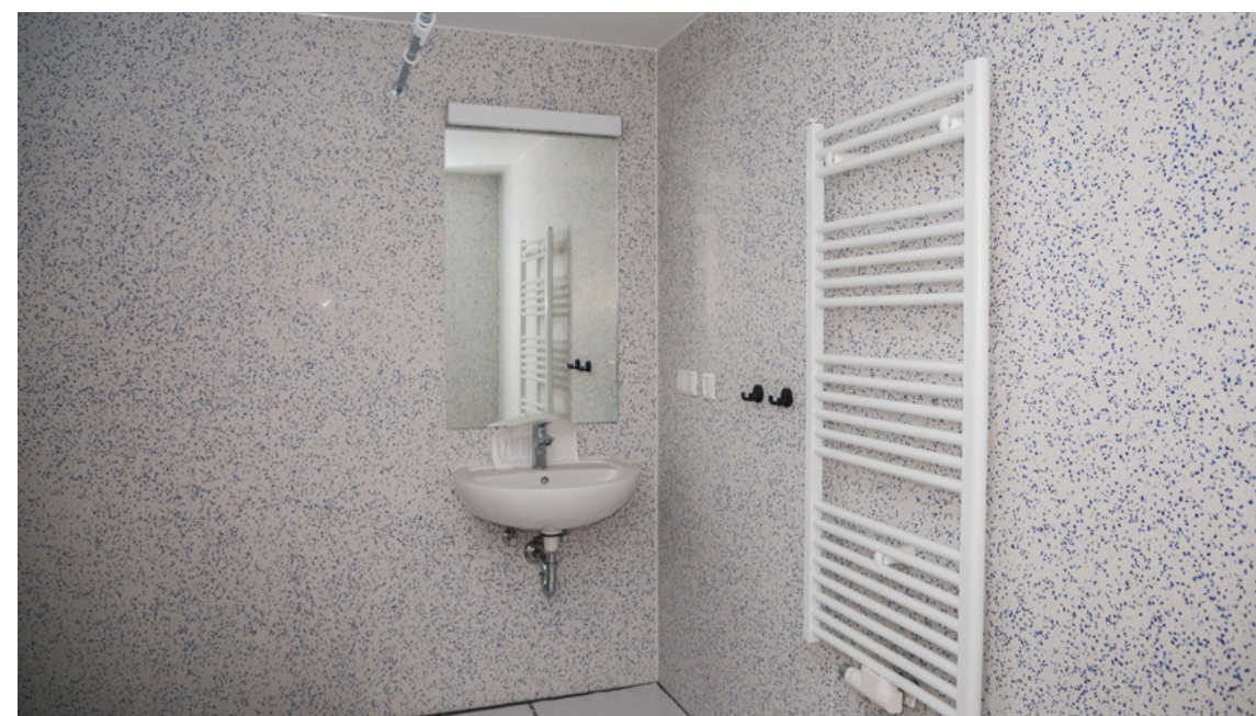
Ein Blick in das Badmodul. Alles ist fertig angeschlossen, fehlt nur die letzte Verbindung mit dem Haussystem. Foto: Karsten Socher
