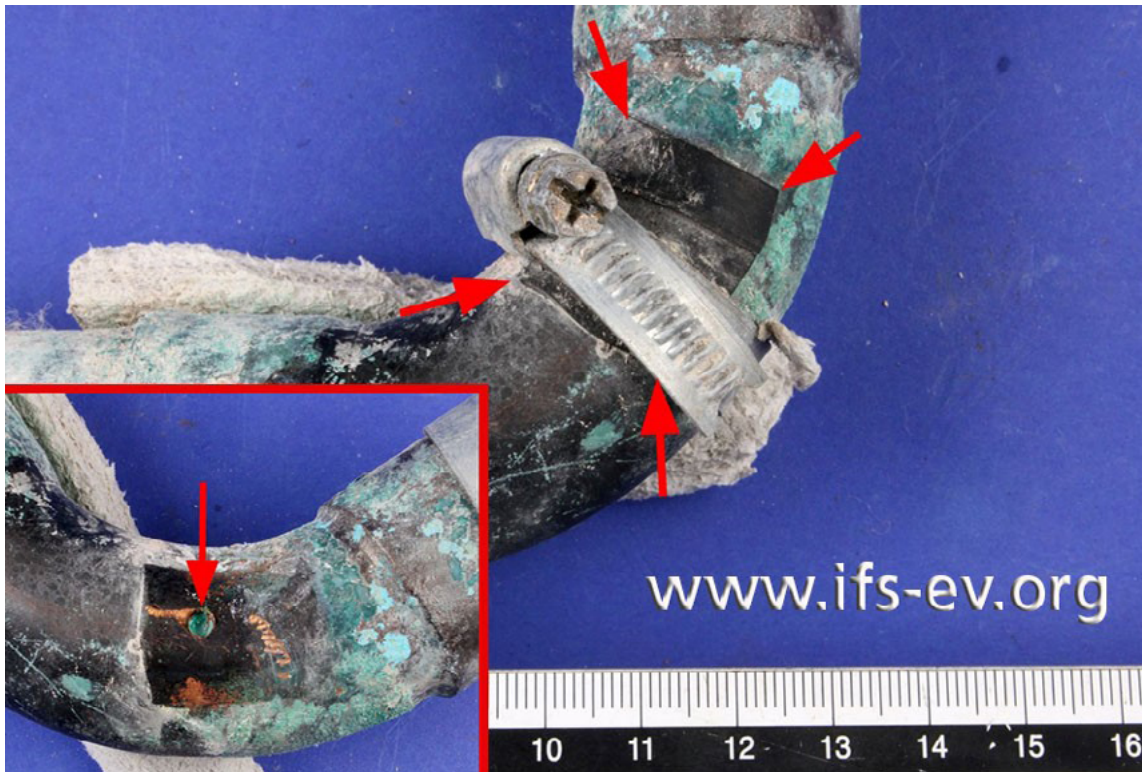
Das große Bild zeigt die provisorisch verschlossene Undichtigkeit, das kleine Bild die kreisrunde Bohrung, die darunter liegt. www.ifs-ev.org
