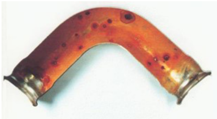
Bild 2: Stark korrodiertes Bogenstück aus der n.r. Stahlinstallation
