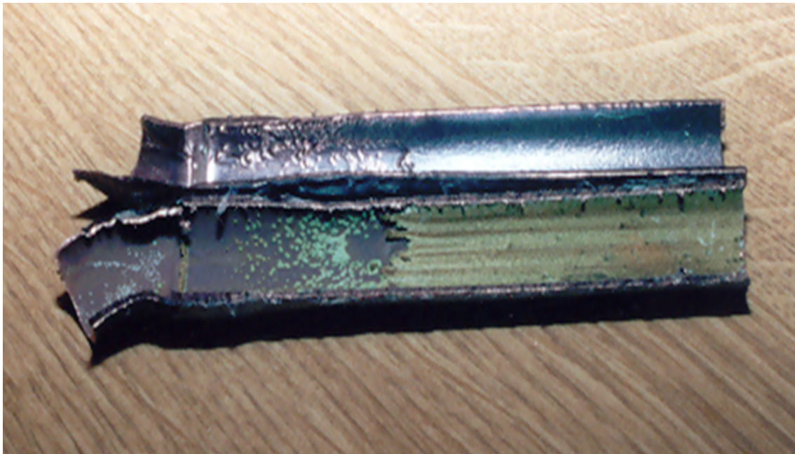
Bild 6: Bei diesem Kupferrohr sieht man im unteren Rohrabschnitt sehr schön die bräunliche Deckschicht, die sich aber im Bereich des Fittings verliert. Man erkennt die Strömungsinhomogenitäten und den wellenartigen Angriff auf den Grundwerkstoff im oberen Bild, die durch Erosionskorrosion hervorgerufen wurde (Quelle: C.Gies, Dinslaken)
