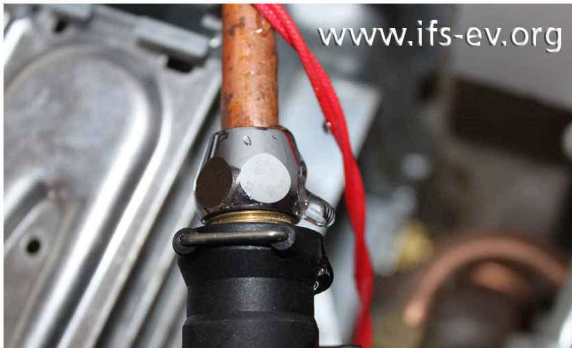
Die undichte Klemmringverschraubung. www.ifs-ev.org .
