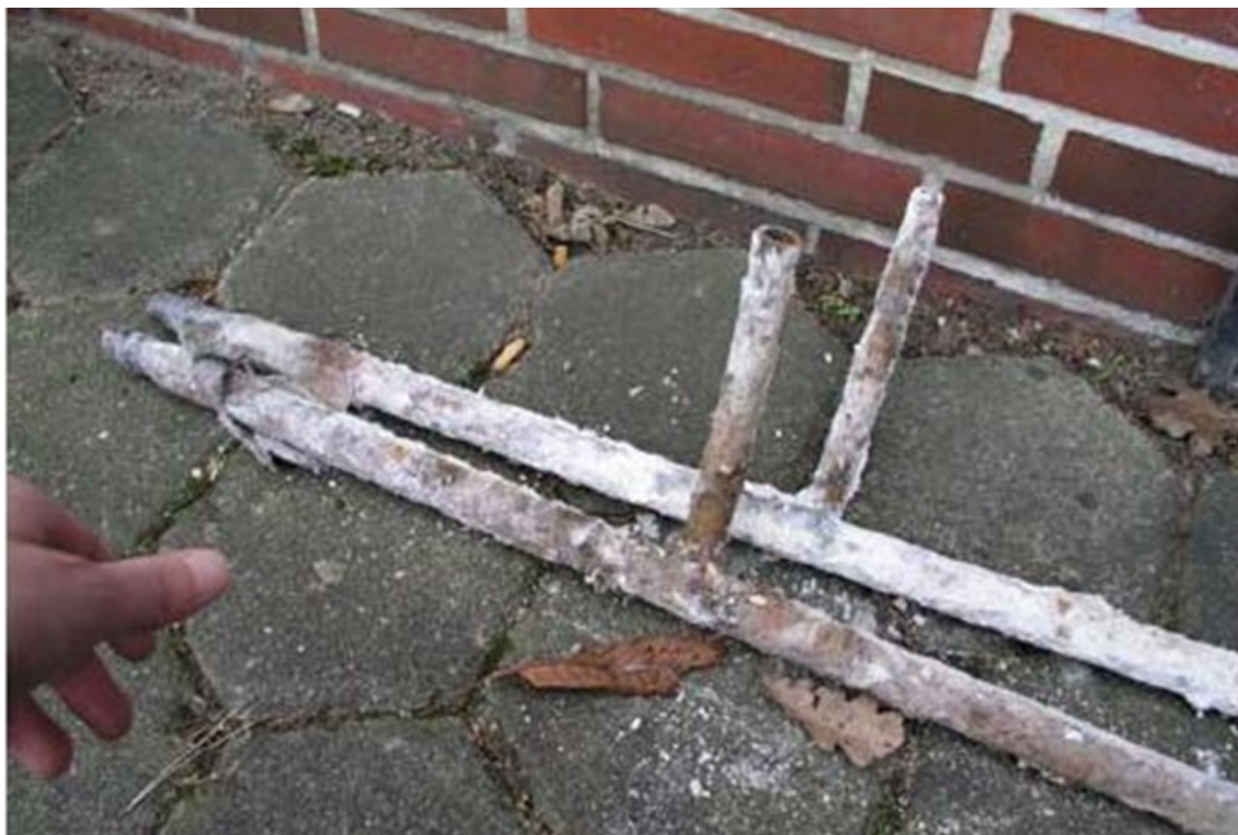
Bild 1: Korrodierte Heizungsrohre ohne Isolierung im Verbundestrich verbaut. (Quelle: Claudia Fricke, Hannover)
