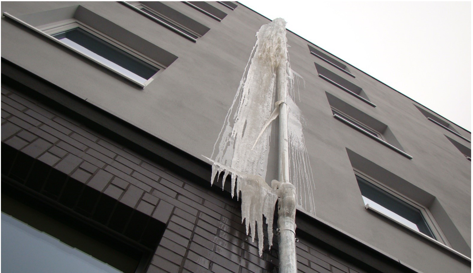
Ein riesiger Eiszapfen bildete sich über Nacht am Fallrohr. Foto: Gerd Warda
