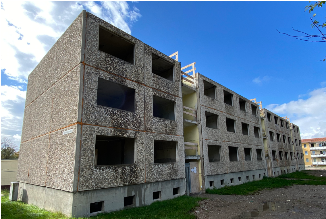
Zwischenzustand: Die oberen beiden Etagen wurden abgetragen und ein Gebäudesegment abgerissen. Foto: Timo Leukefeld
