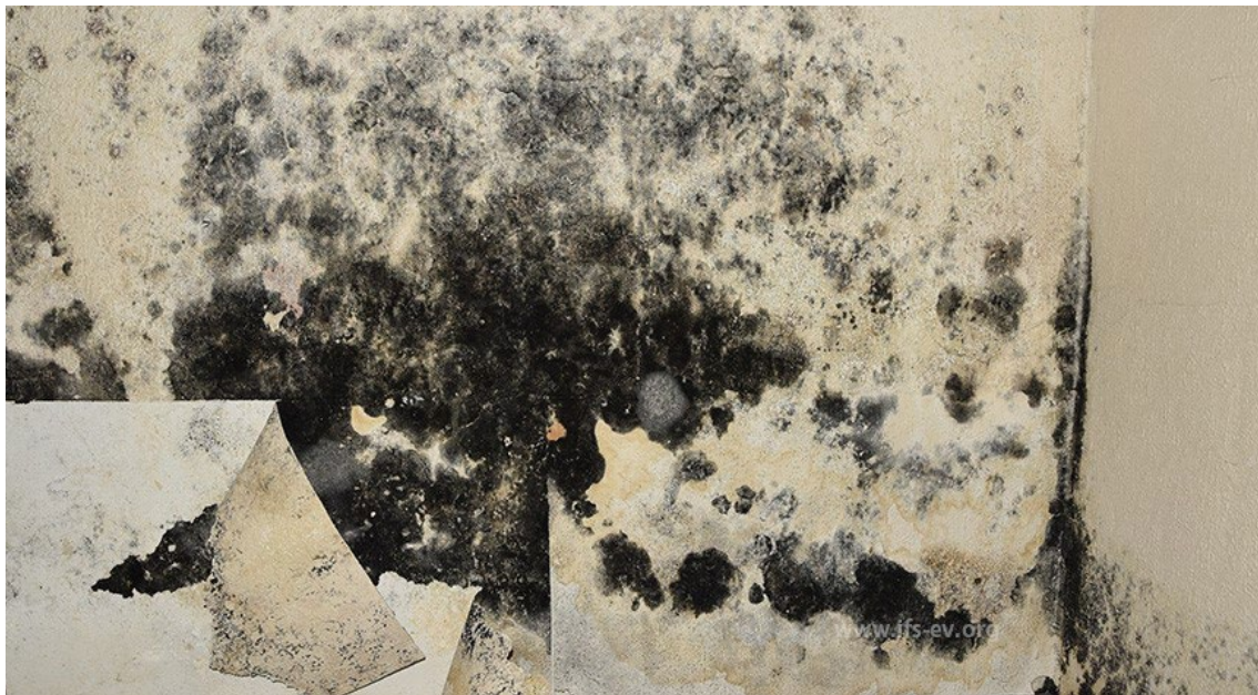
Beispielfoto eines Befalls durch Stachybotrys Foto: www.ifs-ev.org .
