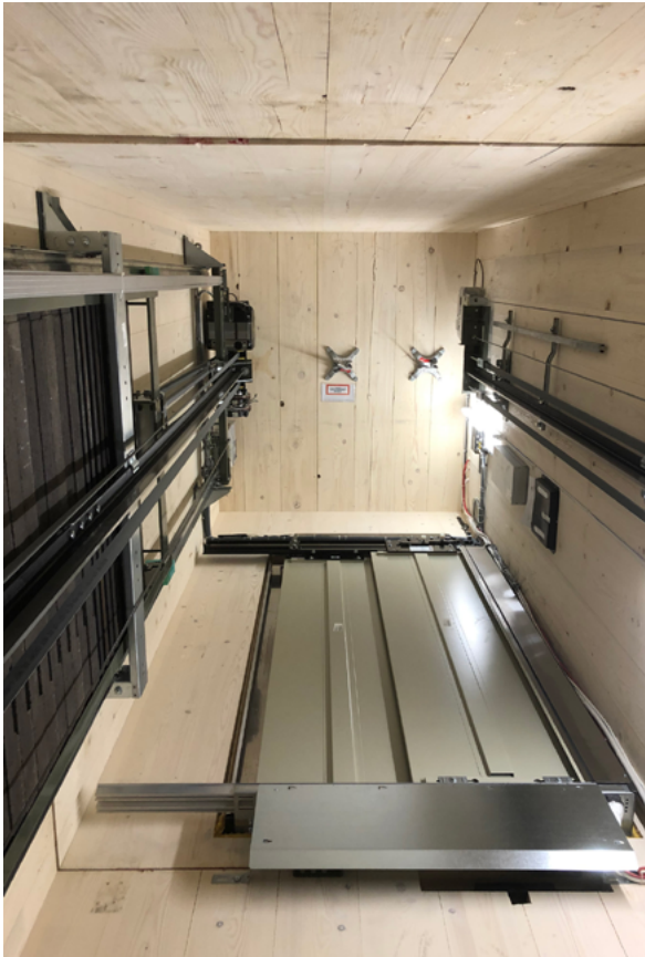
Holzbau macht Schule: Auch der Aufzugschacht besteht vollständig aus dem nachwachsenden Rohstoff. Foto: Schindler
